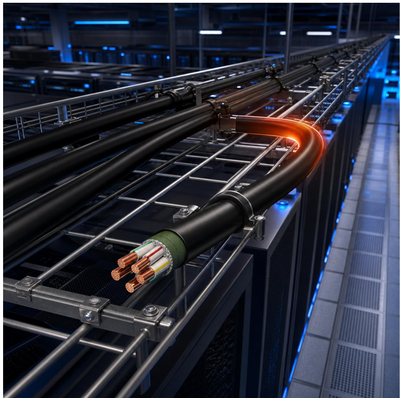
数据中心 / 机房动力系统
